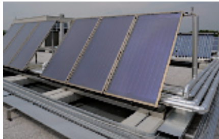
PANNELLI PIANI. Nella foto i sei captatori solari piani installati sul tetto del centro ricerche.
