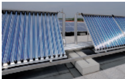
PANNELLI SOTTOVUOTO. Nella foto i sei captatori solari sottovuoto installati sul tetto del centro ricerche.
